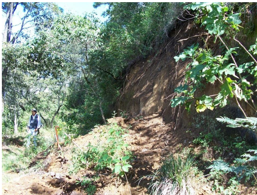
A FIG. 1. Exemplo de descolamento de uma secção vertical de uma calçada na parte superior do Parque Las Penas
